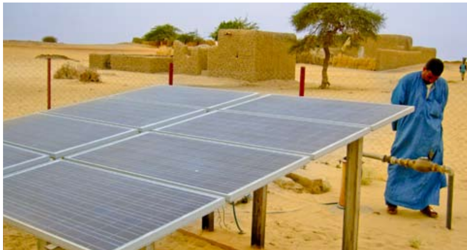
Solare Trinkwasseranlage Boukayatte bei Timbuktu
